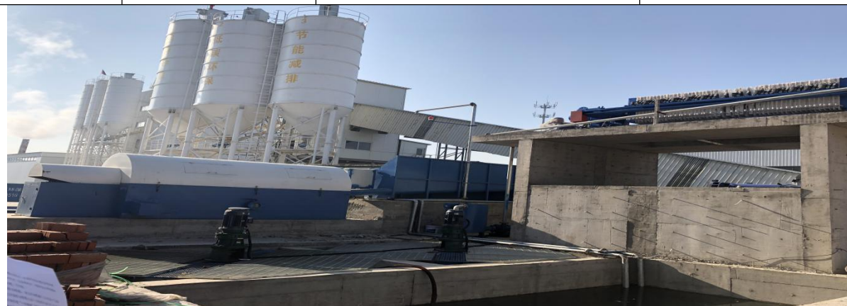
沉淀池+隔油池
